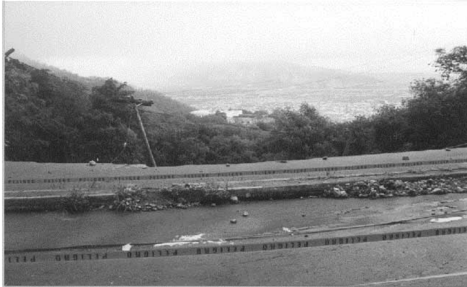
A.9 Vista, cuesta abajo, del derrumbe de la Av. San Ángel.
