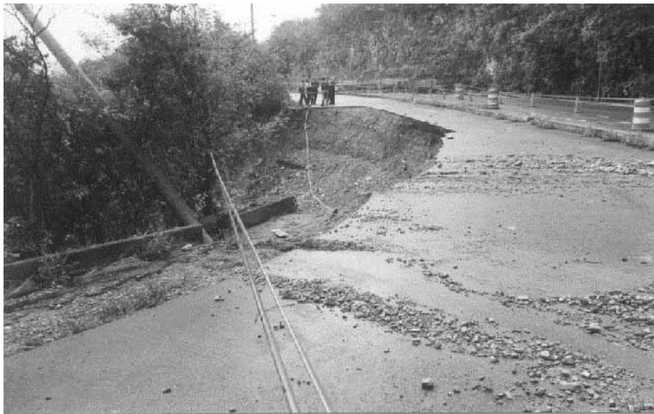
A.10 Otra vista de la falla del talud de la Av. San Ángel.
