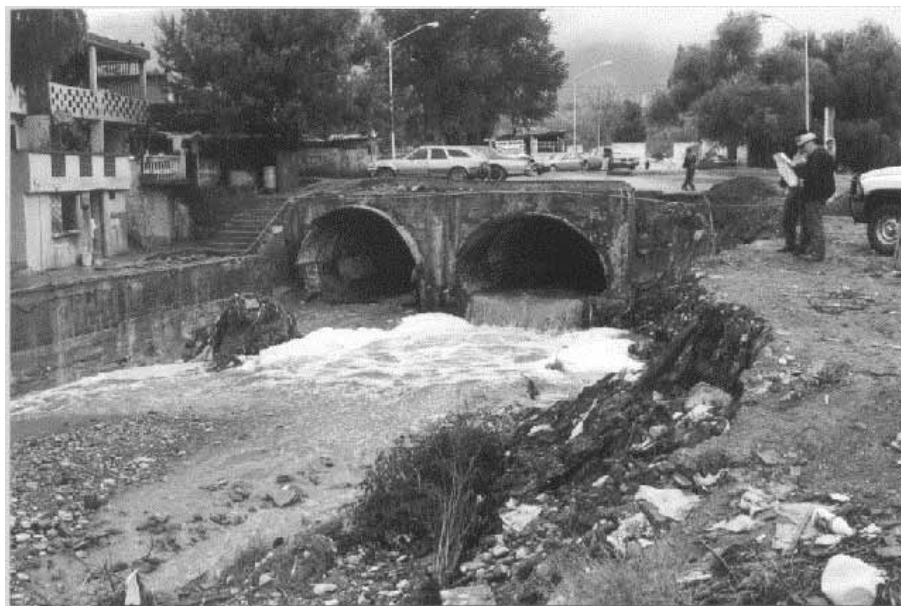
A.2 Alcantarillas a la salida de la confluencia del arroyo El Seco, a la altura del cerro La Campana.
