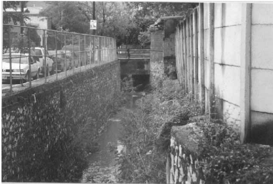
A.6 Entrada de la alcantarilla que pasa por debajo de la calle Vizcaíno, nótese la reducción de la sección transversal.
