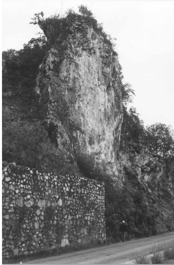
A.11 Macizo rocoso que amenaza con desprenderse y bloquear la entrada a la zona de San Ángel.
