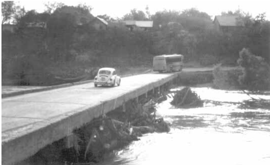
A.18 Ramas y troncos acumulados en las pilas del puente que cruza el río Guayalejo
