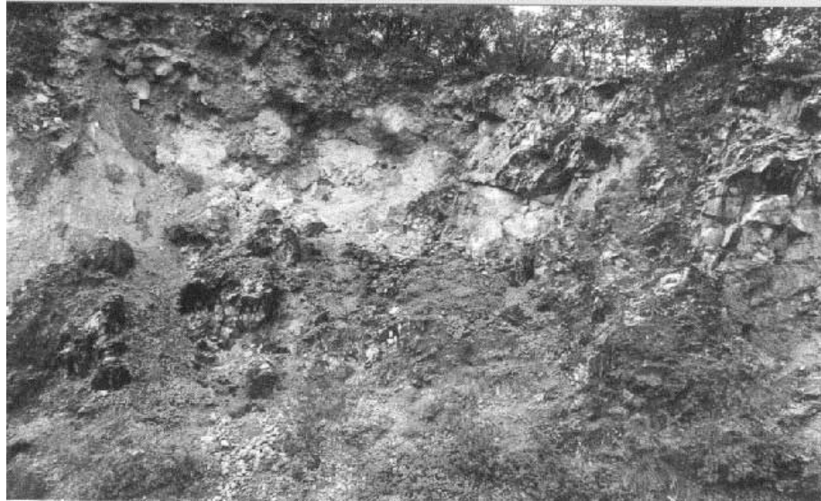
A.13 El macizo rocoso donde está el corte anterior, presenta desgaste debido a un proceso de intemperismo.
