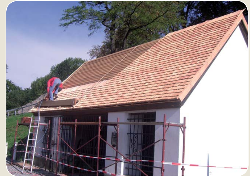
Die Sanierungsmaßnahmen auf dem Schloßberg wurden durch die Erneuerung des Daches der Kanonenhütte fortgesetzt.
