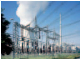
Kernkraftwerk Isar 2, weltweit seit Jahren das Kernkraftwerk mit der höchsten Stromerzeugung
