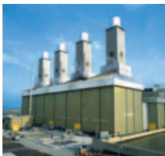
Gaskraftwerk Connah's Quay, Großbritannien
