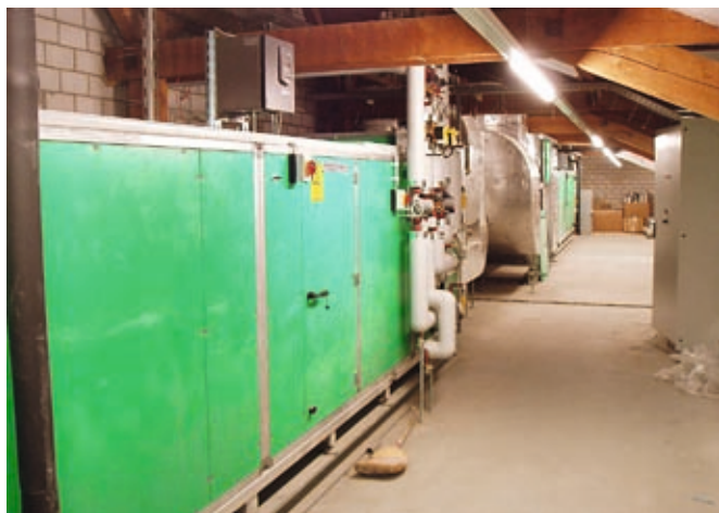
Die Neuerungen machten auch vor den Technikräumen nicht Halt.
